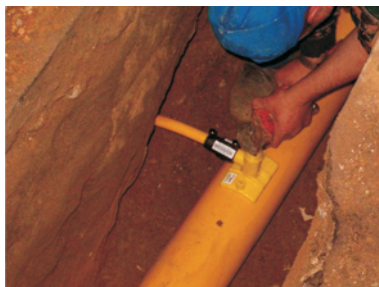
Widok początku przyłącza do sieci gazowej Źródło: http://www.gazowniaserwis.com.pl/
