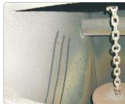
Fot. 3. Kocioł z usuniętym awaryjnym rusztem wodnym.
