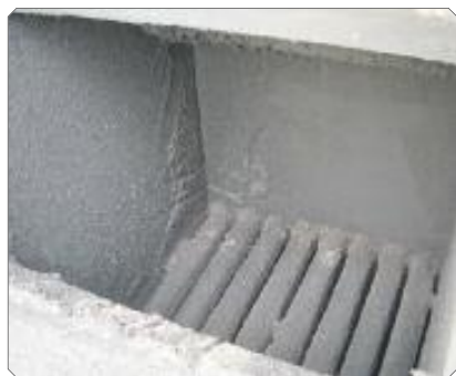
Fot. 1. Kocioł retortowy z awaryjnym rusztem wodnym - widok na ruszt wodny.
